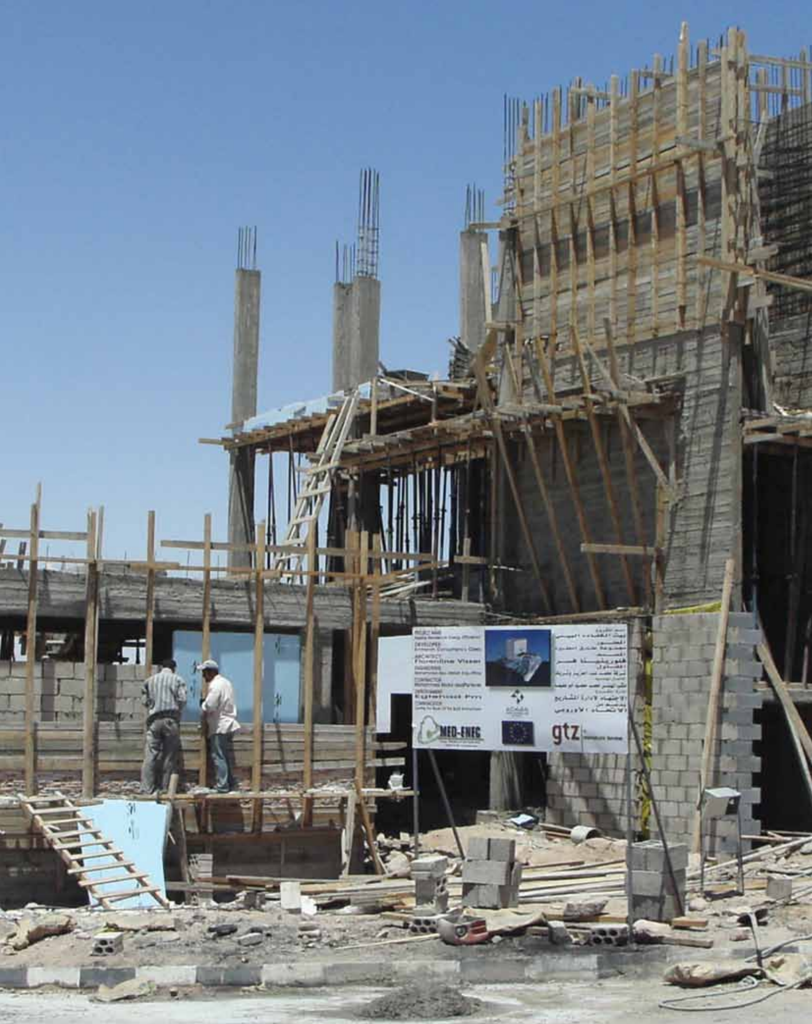
مشروع العقبة ريزيدنس (AREE) لترشيد استخدام الطاقة بالأردن - (تحت الإنشاء). قد تم تصميمه وفقاً لنهج التصميم البيئي السلبي. ولقد وفرت تدابير كفاءة استخدام الطاقة المستخدمة نسبة ٢٢٪ من صافي طلب المبنى من الطاقة. كما أضافت ١٢٪ على تكاليف البناء مقارنة بالمباني التقليدية. ومع ذلك تم حساب المردود حيث تبين أن هذه التكلفة الإضافية سوف تسترد - من خلال خفض فاتورة استهلاك الطاقة - خلال أقل من أربعة سنوات. المهندس المعماري: فلورنتين فيسر.
