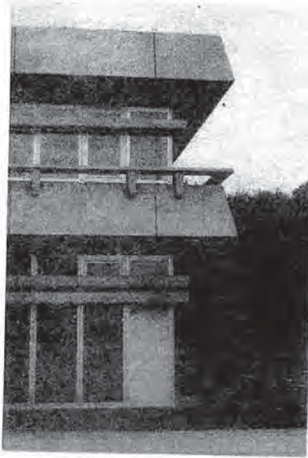
شكل (٤٢) - جامعة أزم. تفصيلة لأحد الأركان تبين الأجزاء الخرسانية سابقة الصب والدرابي، الفرازينات أو الكوستات مع فواتمها، والواجهات السابقة الصنع ومجاري حفظ السناير الخارجية التي تستعمل لمنع اشعة الشمس.
