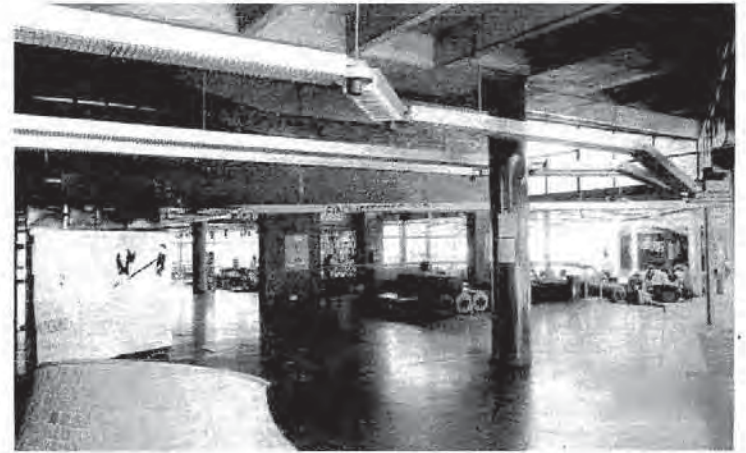
شكل (١٦٥) جامعة كوستناتز: مستوى آخر من منطقة المشاة الرئيسية وترى كافة الأعمال الانشائية وأعمال الإنارة والتكييف بوضوح.
